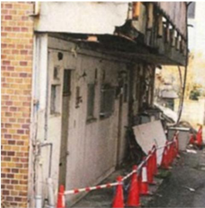
外壁剥落等の危険な状態
