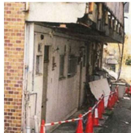
外壁剥落等の危険な状態
