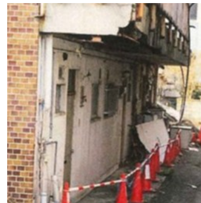
外壁剥落等の危険な状態
