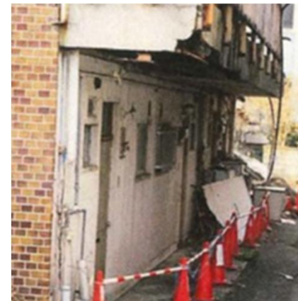
外壁剥落等の危険な状態
